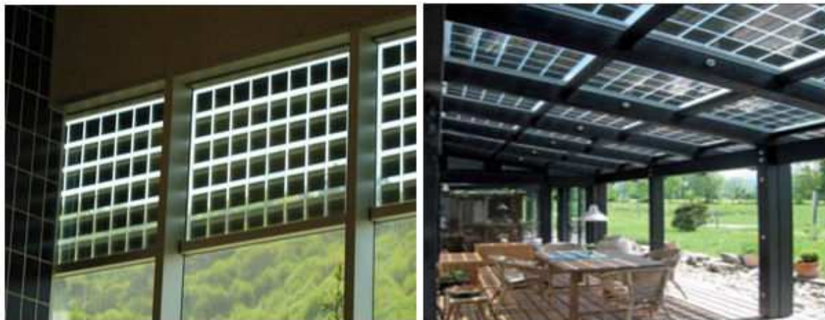
Rys. 21. Panele fotowoltaiczne zamontowane na części powierzchni okna oraz jako element dachu [2]
