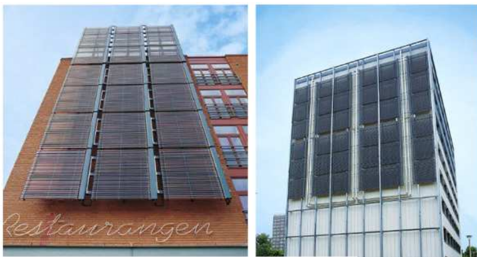
Rys. 15. Kolektory słoneczne na ścianach budynków [3]
