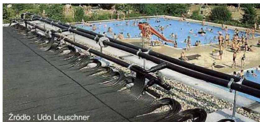
Rys. 14. Kolektory bez przykrycia szybowego podgrzewające bezpośrednio wodę basenową [3]
