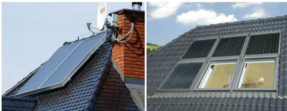
Rys. 16. Kolektory słoneczne na dachu oraz wkomponowane w połąc dachową [4],[2]
