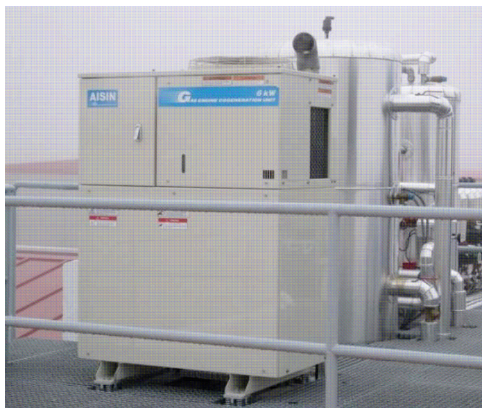
Fot. 5 Kogenerator MCHP AISIN model GECC60A2
