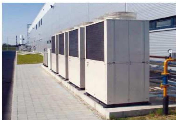
Fot.1 Urządzenia GHP usytuowane poza budynkiem
