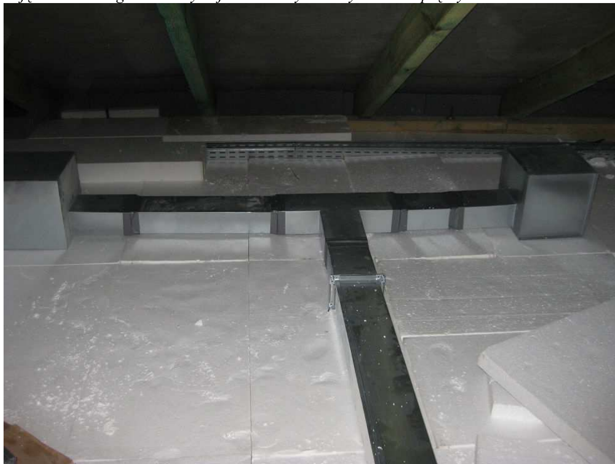
Zdjęcie nr 4: Fragment wentylacji z widocznymi skrzynkami rozprężnymi
