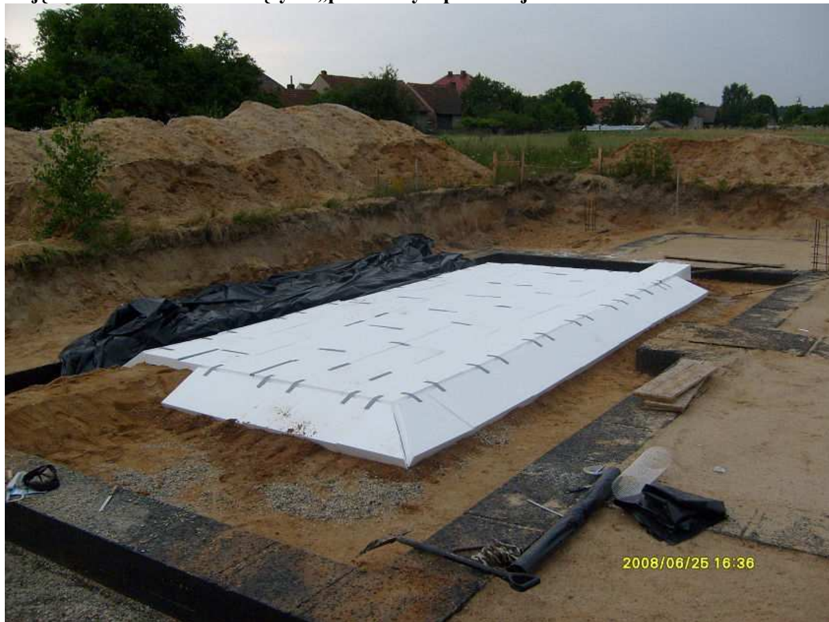
Zdjęcie nr 3: GWC zamknięty w „puszce styropianowej”
