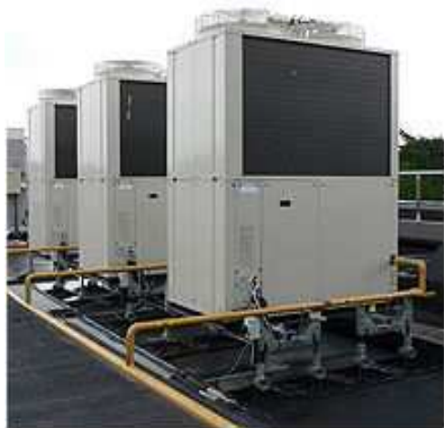
Fot.2 Urządzenie GHP na dachu budynku
